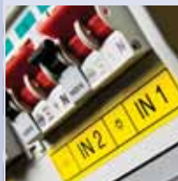
Skrzynki rozdzielcze i tablice połączeń
