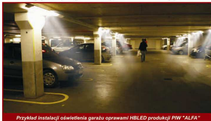
Przykład instalacji oświetlenia garażu oprawami HBLED produkcji PIW „ALFA”
